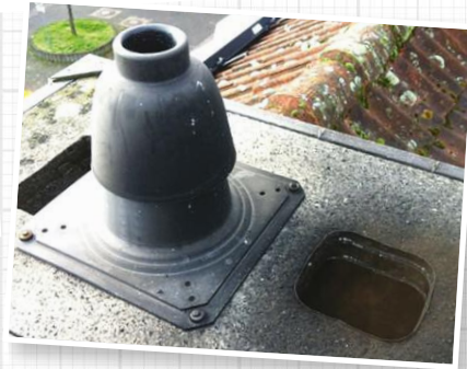
Falsche Ausführung der Mündungssituation bei nebenliegenden Abgasanlagen
